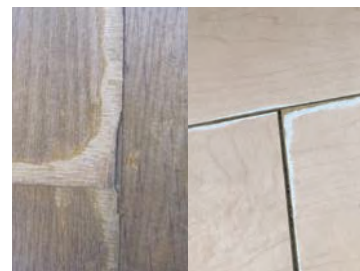
摩耗して下地が露出
